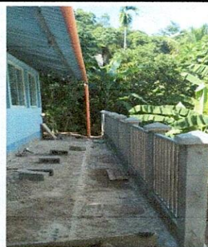
Foto 4: Módulo 10, muro de contención
