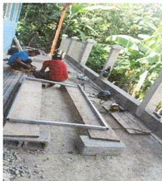
Foto 1: Módulo 10, muro de contención
