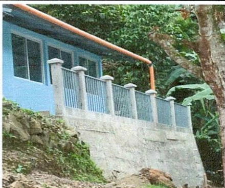
Foto 3: Módulo 10, muro de contención
