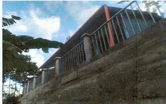
Foto 2: Módulo 10, muro de contención
